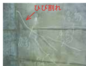
写真-2 主構のひび割れ
