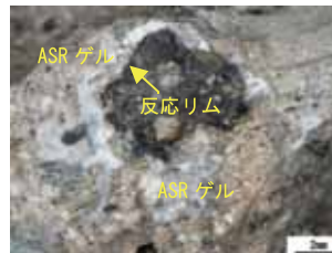
写真-5 主構外側（P1-P2間）ASRゲル発生状況
