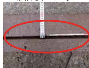
写真-4 伸縮装置の状況 (止水性低下)
