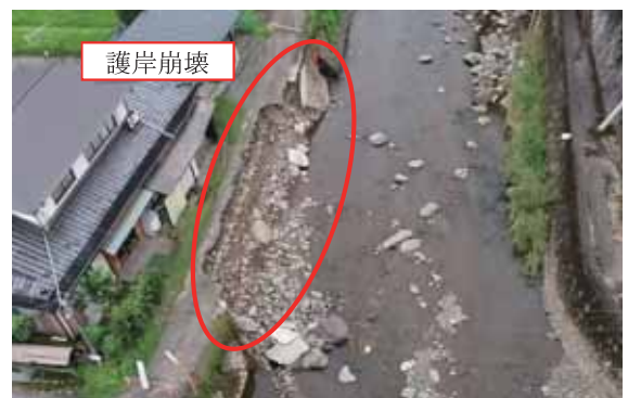
写真-1 被害状況一部
