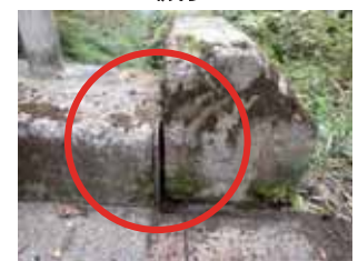
写真-5 地覆部の状況 (止水材無)
