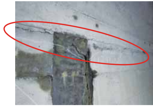
写真-3 水平打ち継ぎ目部のうき
