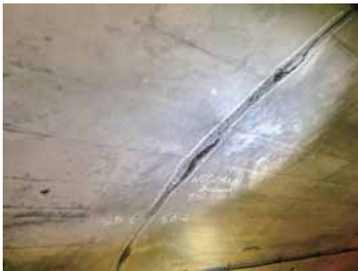
写真-4 横断目地部のうき(全景)
