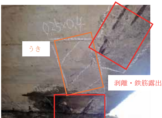
写真-2 床版下面の損傷
