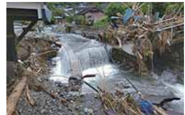
写真-1 調査地災害状況
