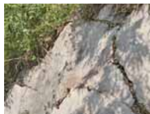
写真-7 法面左上部の割れ状況
