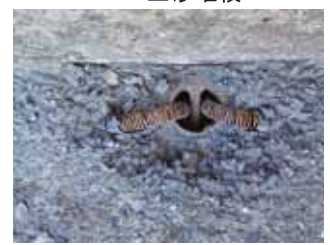
写真-9 応急措置
