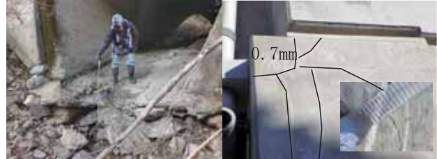
写真-10 橋台前趾洗堀
