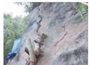
写真-8 ひび割れ・空洞化状況
