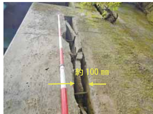
写真-1 橋台の開き
