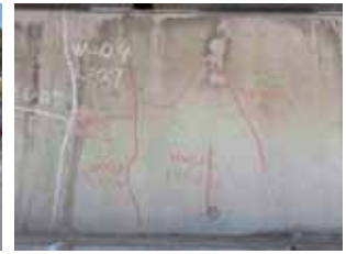
写真-2 A2橋台 堅壁ひびわれ状況
