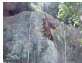
写真-5 剥離箇所状況
