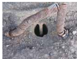
写真-8 橋面排水管 (スパイラル管の逸脱)
