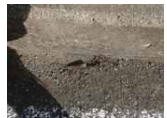
写真-7 橋面排水柵土砂堆積
